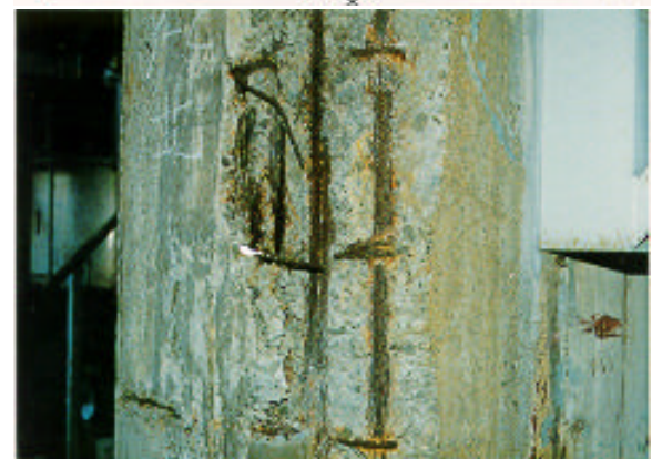
<그림-1> 철근콘크리트 구조물의 염해 사례
